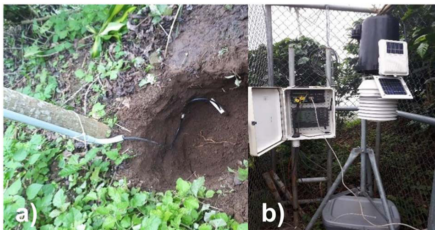
Figura 1. a) Instalación de un sensor de reflectometría de dominio temporal (TDR); b) un datalogger y una estación meteorológica en Llano Brenes, Alajuela, Costa Rica, 2018 - 2019.
