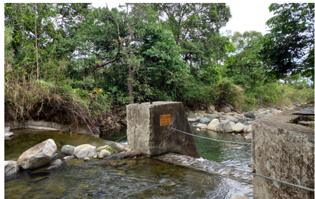
Figuras 5 y 6. Toma de agua y tubería de Pindeco en el río Volcán
