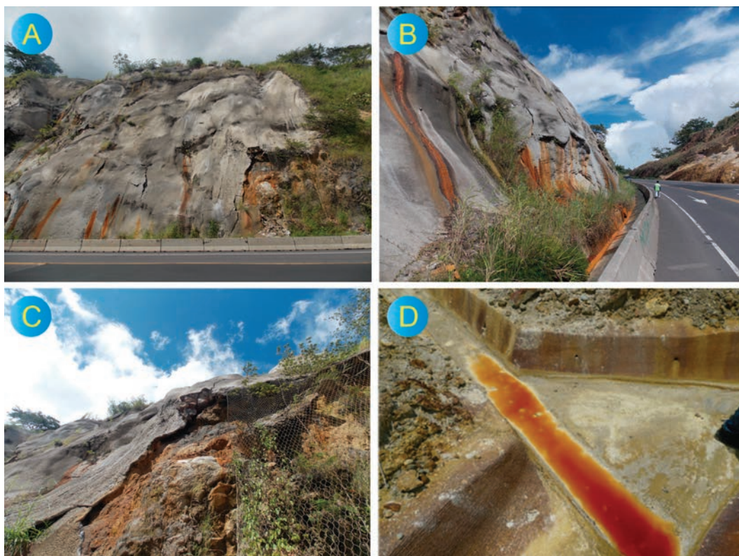
Fig. 10: A) Concreto lanzado con pátinas de óxidos de hierro en la parte inferior. B.) En la parte central se observa la cuneta con acumulación de óxidos de hierro. C) Colapso de concreto lanzado que deja expuesto el acero de las mallas electro-soldadas. D) Acumulación de aguas con coloración rojiza en una cuneta ubicada en la segunda berma del talud LD estacionamiento 48+000 de la RN- 27. Nótese los bordes de color blancuzco producto de la reacción del componente calcáreo del cemento de la cuneta y el agua ácida.
