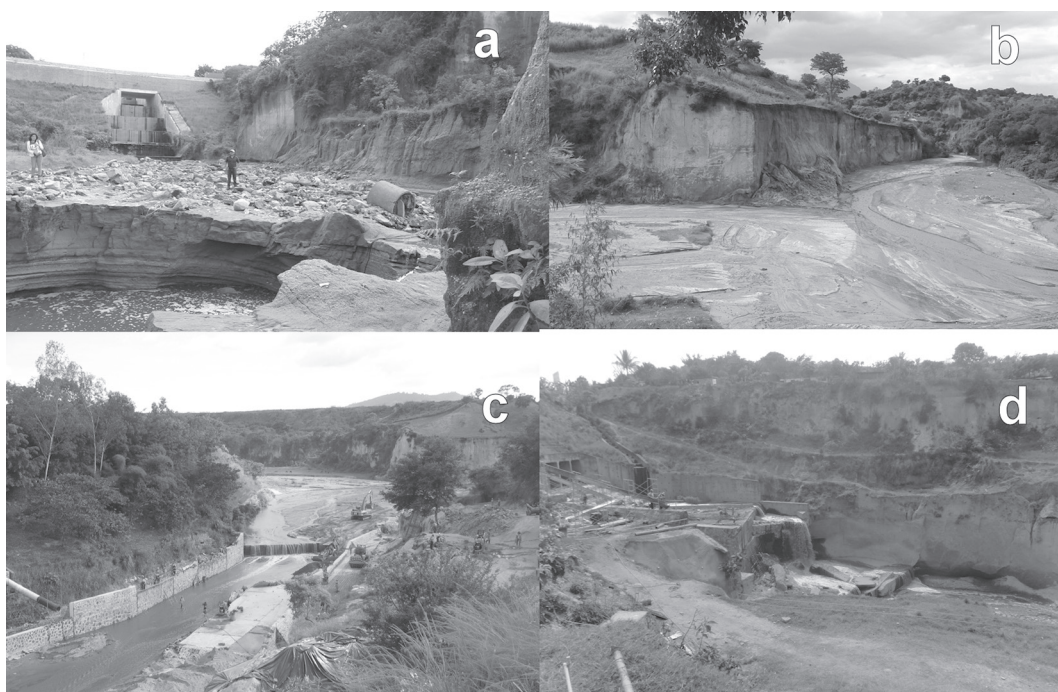
Fig. 3: Problemas de denudación y situación de laderas de los ríos y quebradas. En (a) y (d) se muestra erosión retrograda en obras de paso.
