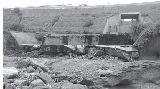
Fig. 7: Situación de la obra de paso en Noviembre 2015 (punto 5 de Fig. 5 y Fig. 3a) cuando ya estaba afectada nuevamente por erosión retrograda
