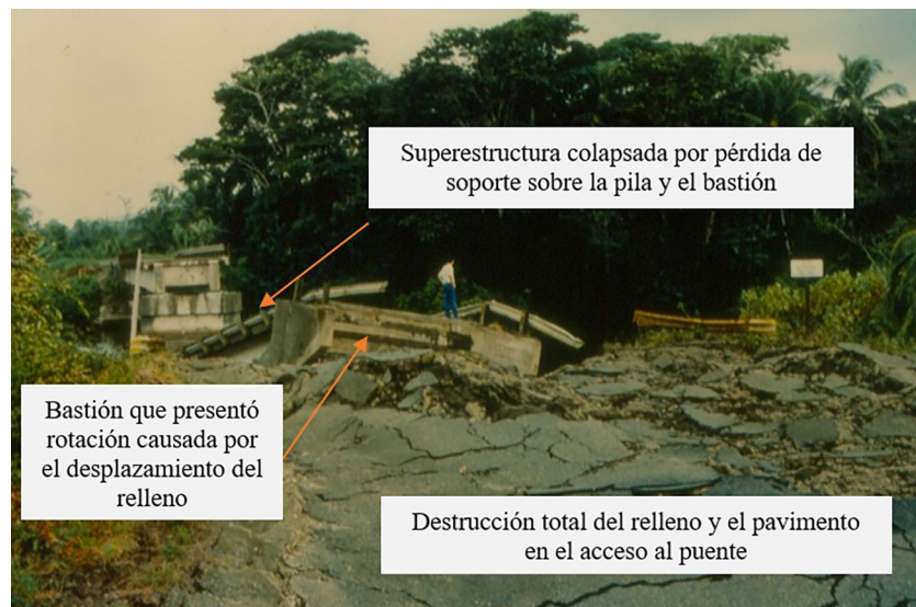
Fig. 3: Destrucción del acceso al puente (puente sobre el río Bananito en la Ruta Nacional 36). Este puente presentó el colapso del puente y la destrucción completa de la vía de acceso (Fotografía: Laboratorio de Ingeniería Sísmica, Universidad de Costa Rica).
