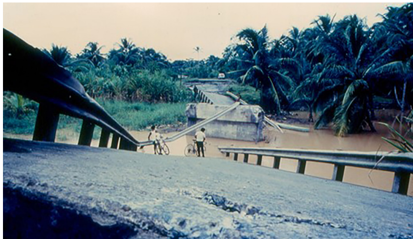
Fig. 4: Estado del puente sobre el río Bananito (Ruta Nacional 36) después del terremoto de Limón. Este puente presentó la pérdida de soporte de la superestructura, ruptura de los pernos de anclaje, rotación de los bastiones y desplazamiento del relleno. En este caso, las dos superestructuras que formaban el puente sufrieron la pérdida de soporte (Fotografía del Laboratorio de Ingeniería Sísmica, Universidad de Costa Rica).
