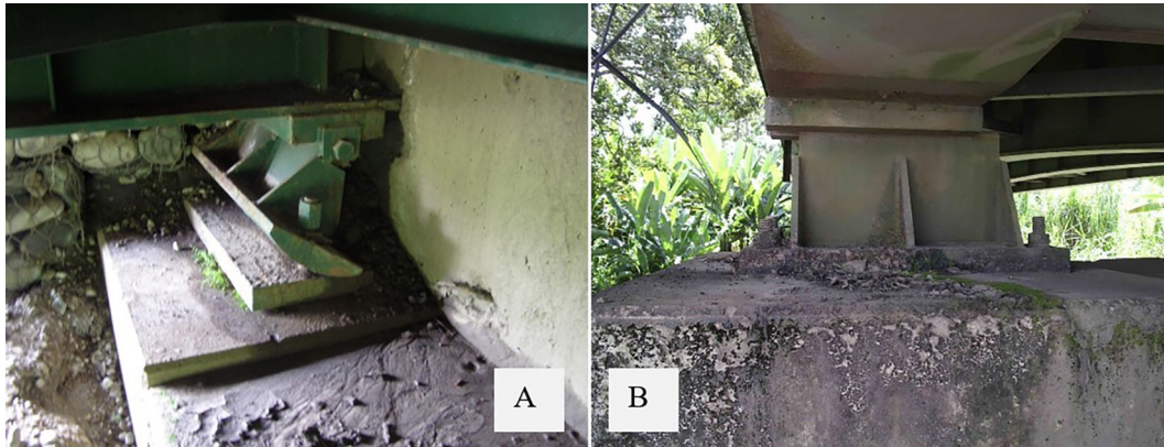
Fig. 10: Desplazamientos permanentes en los apoyos provocados por el terremoto de Limón. En la fotografía A se muestra un desplazamiento en la dirección longitudinal del puente y en la fotografía B el desplazamiento transversal observados en el puente sobre el río Chirripó (Fotografías Unidad de Puentes, Laboratorio Nacional de Materiales y Modelos Estructurales)
