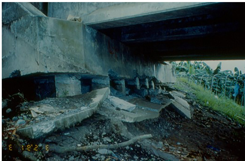
Fig. 6: Condición de los pilotes en los bastiones del puente sobre el río Cuba (Ruta Nacional 32) después del terremoto de Limón (Fotografía: Laboratorio de Ingeniería Sísmica, Universidad de Costa Rica).
