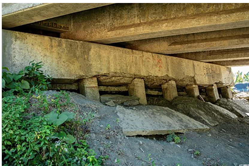
Fig. 7: Condición de los pilotes en los bastiones del puente sobre el río Cuba (Ruta Nacional 32) en el año 2019 (Fotografía: por Laboratorio Nacional de Materiales y Modelos Estructurales, Universidad de Costa Rica).
