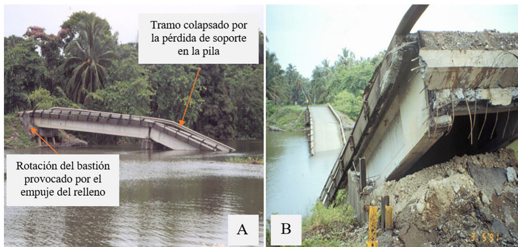
Fig. 5: Vistas del puente sobre el río Vizcaya en la Ruta Nacional 36 después del terremoto de Limón. En la fotografía A se aprecia la rotación del bastión y uno de los tramos colapsados. En la fotografía B se muestran los tramos colapsados vistos desde el acceso Sureste (Fotografías del Laboratorio de Ingeniería Sísmica, Universidad de Costa Rica).
