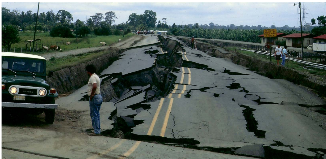
Fig. 7: Desplazamiento lateral y ruptura del relleno compactado de la carretera (RN-32) cerca de la localidad de Río Blanco. Fotografía tomada por Sergio Mora Castro el 24 de abril de 1991.
