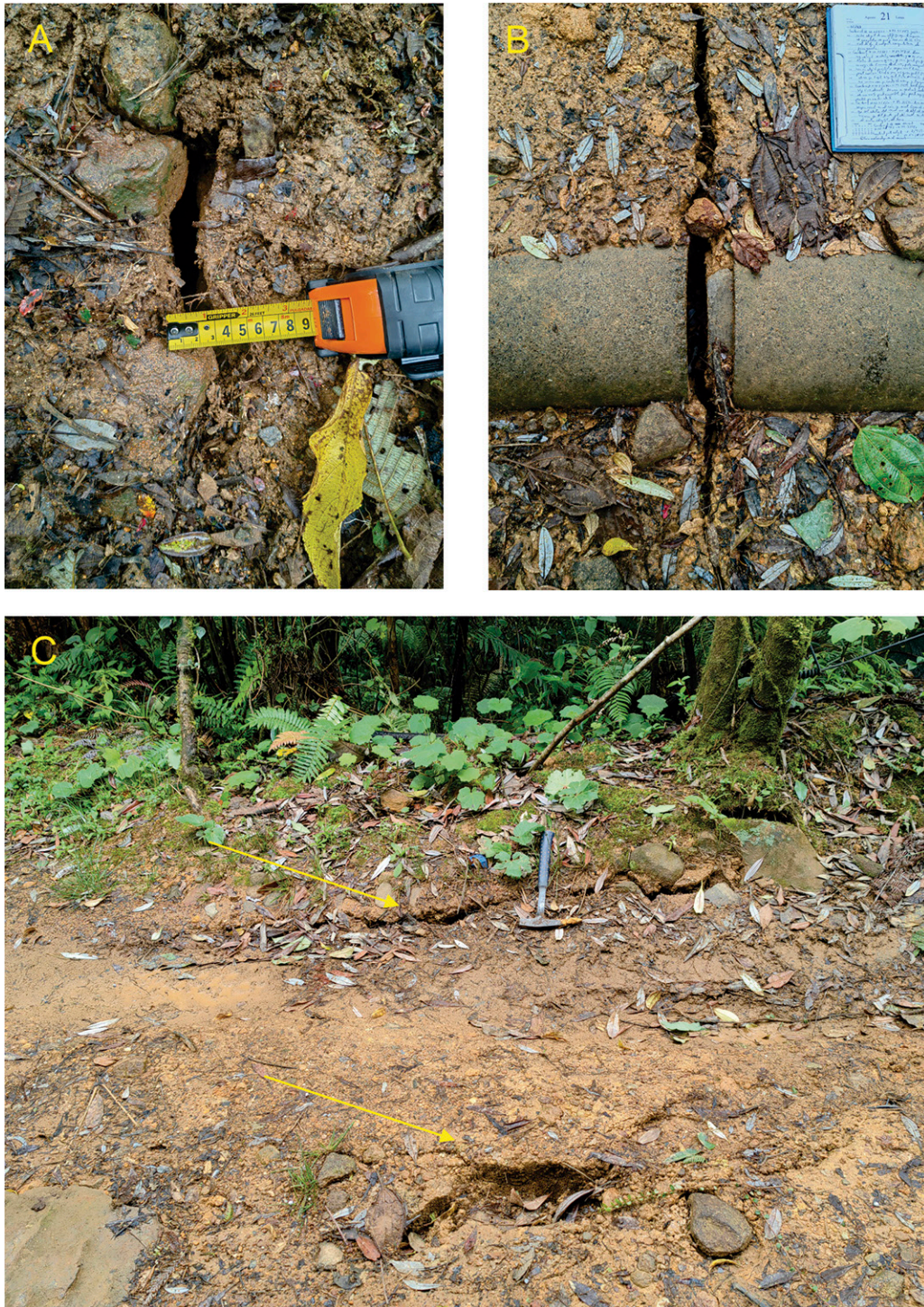
Fig. 5: Agrietamientos en el Sendero Pozo Verde. A. Fisuras abiertas de 3 cm de ancho. B. Alcantarilla movida por el agrietamiento. C. Se estima que los agrietamientos EW abiertos corresponden con el área de la corona del deslizamiento activo del sendero.
