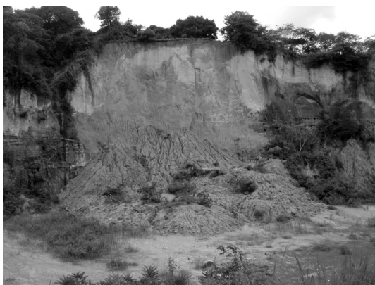
Fig. 5: Movimiento de ladera en TBJ (combinación de derrumbe y volcamiento) en escarpes de quebrada, sector corresponde a cuenca alta de río Las Cañas.
