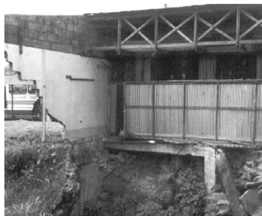
Fig. 9: Carnicería colapsada debido a la erosión ocasionada por el río Colorado durante la inundación de febrero de 1996.
