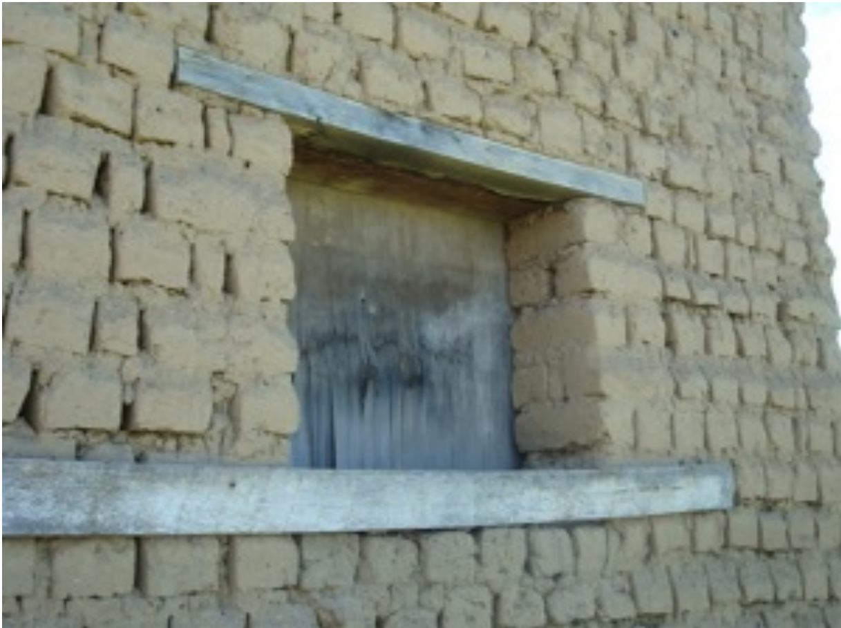
Figura 9. Dintel de ventana con deformaciones
