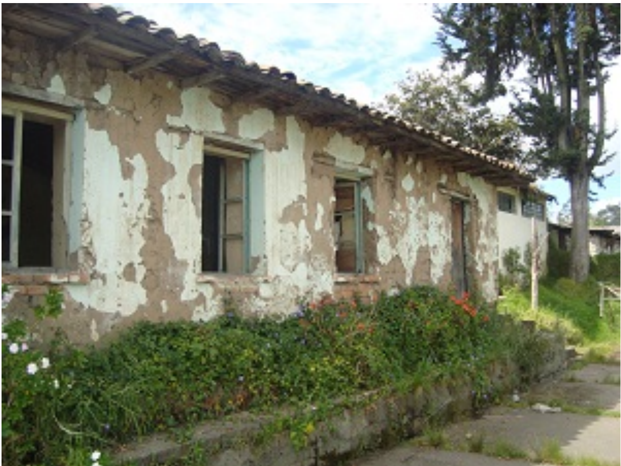
Figura 7. Fachada con desprendimiento de enlucido
