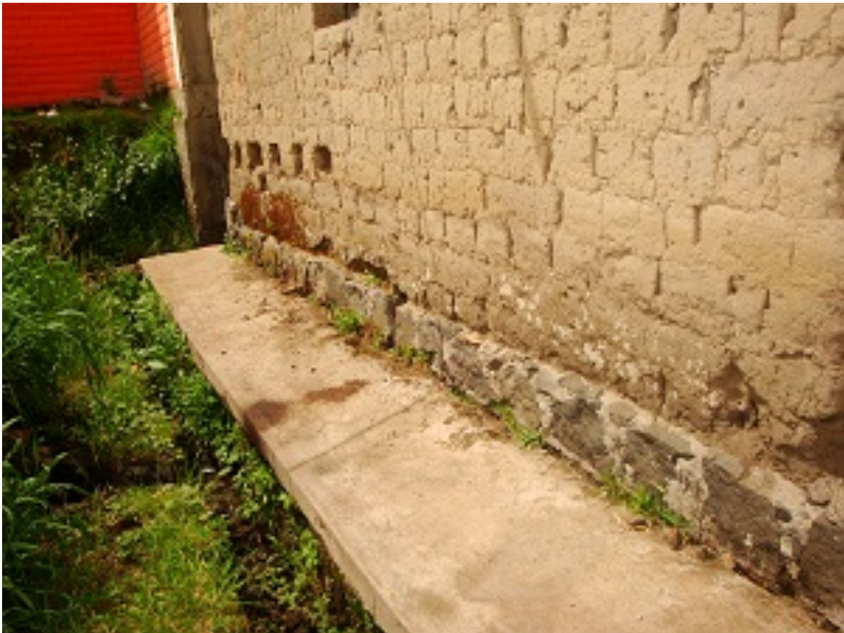
Figura 4. Crecimiento de vegetación en cimiento
