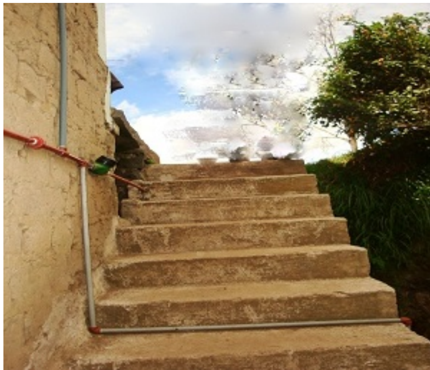
Figura 11. Instalación de Agua Potable vista
