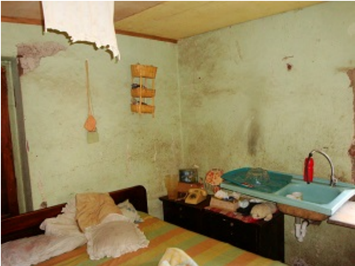
Figura 8. Patologías encontradas en paredes interiores. Desprendimiento de enlucido
