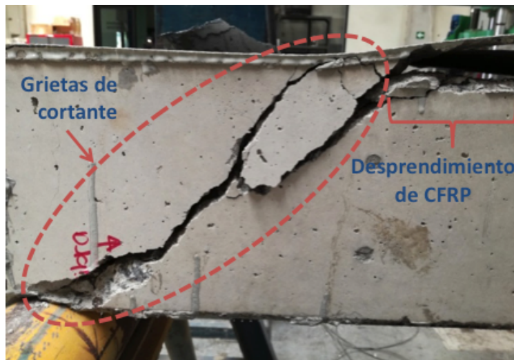
Figura 10. Grietas de cortante y desprendimiento de la fibra de carbono en el centro de la losa LR1
