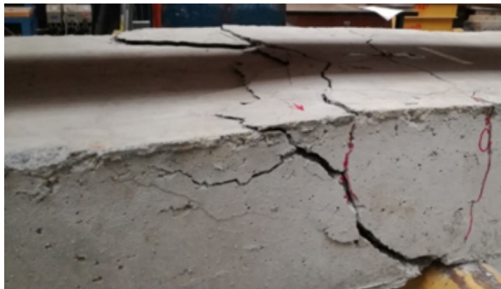
Figura 7. Patrón de grietas en la zona central de la losa, momento negativo
