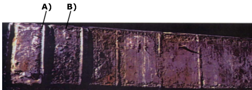
Fig. 3. Barra de hidrogenador con daño debido a chispas por vibración: A) no deterioro en las zonas de los ductos de ventilación, B) gran deterioro en las zonas de contacto con el núcleo de estator. Fuente: [11].
