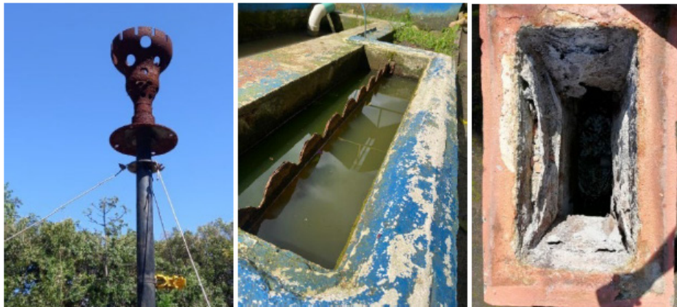
Fig. 2. Evidencia de corrosión de elementos de concreto y acero en PTAR: (a) antorcha de acero al carbono; (b) vertedores de acero; (c) interior de tanque de concreto corroído.
