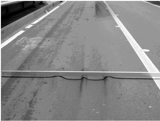
Figura 1. Fenómeno del ahuellamiento. Vía Calle 80, Bogotá, Colombia.
