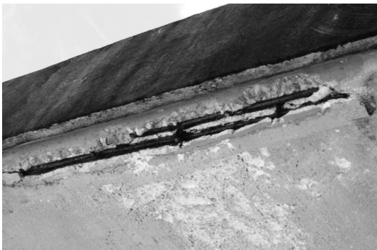
Figura 2. Daños por corrosión en nervio perimetral de la cubierta.
