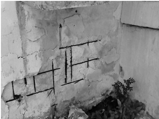
Figura 1. Muro de concreto dañado por corrosión del acero de refuerzo.
