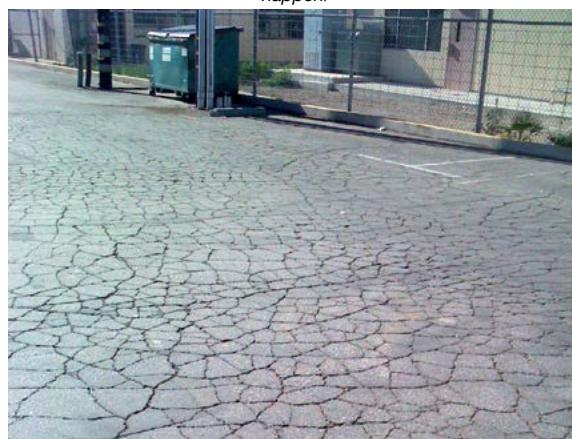
d. Grietas daño por humedad
