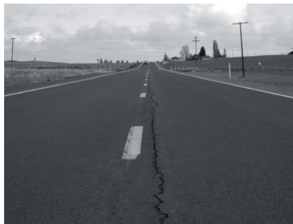
b. Grieta longitudinal
