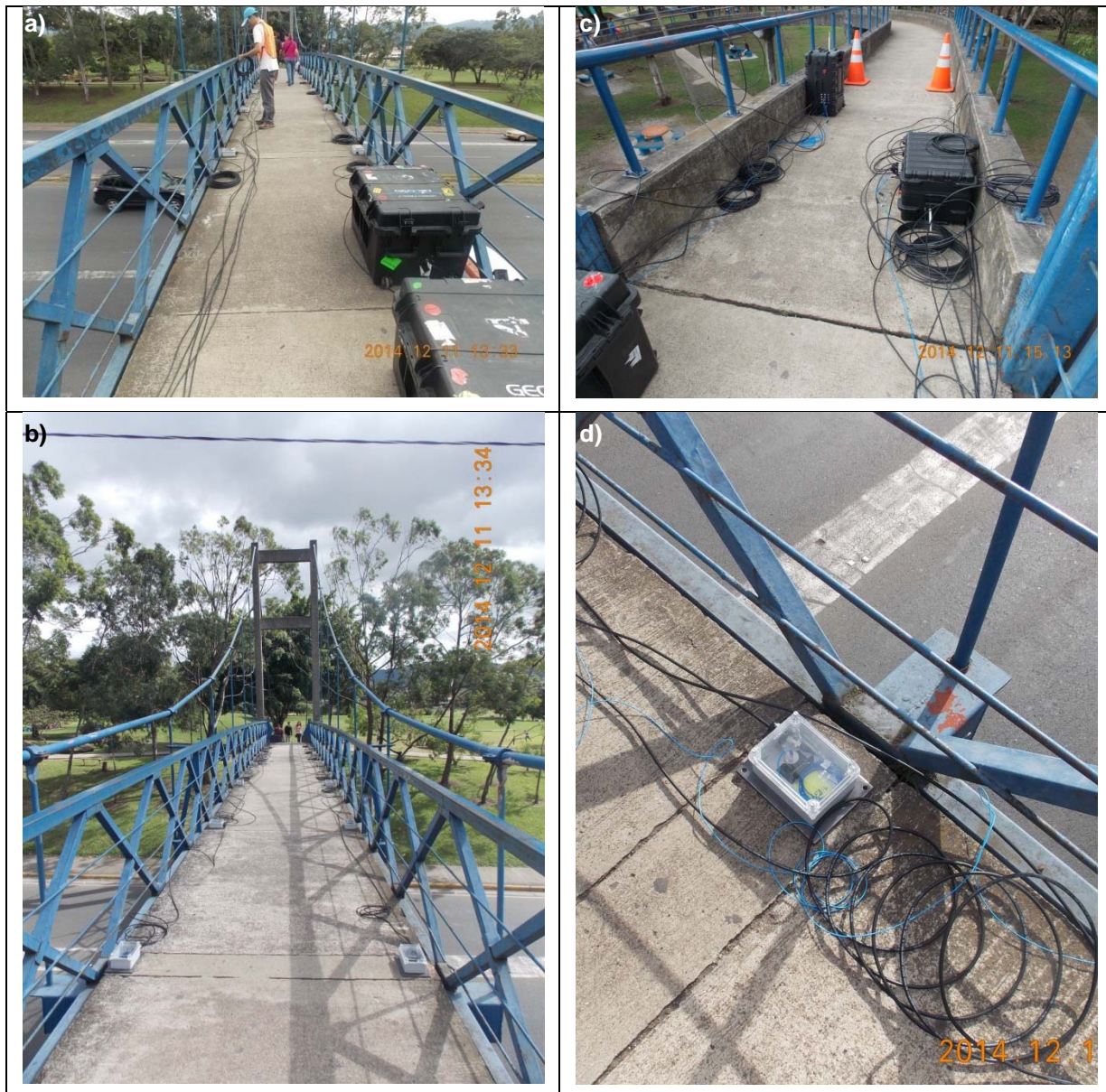
Figura 60. Fotografías de la instrumentación del puente peatonal de parque de la Paz: a) cableado y conexión de acelerómetros, b) finalizado el cableado y conexión de acelerómetros con cRIO's, c) ubicación de los cRIO's en los accesos al puente peatonal, d) un acercamiento a la caja de protección de acelerómetros.
