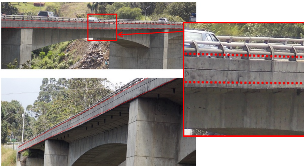
Figura 2. Deformación vertical del tramo 3. Arriba visto desde el norte, abajo vista desde el sur
