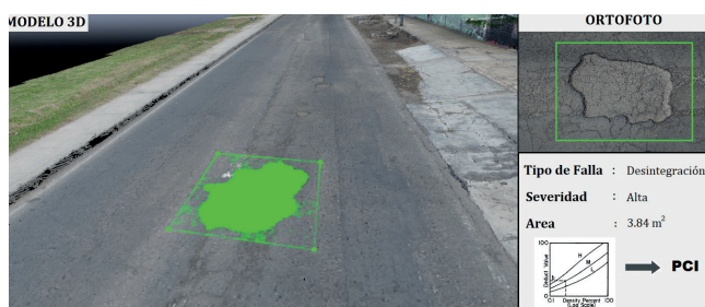
Figura 16. Identificación visual y metrado de fallas del pavimento
