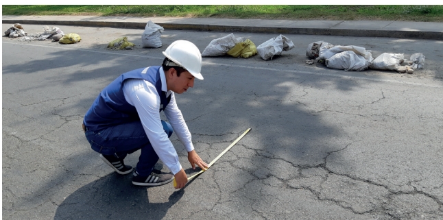
Figura 4. Medición de la falla identificada
