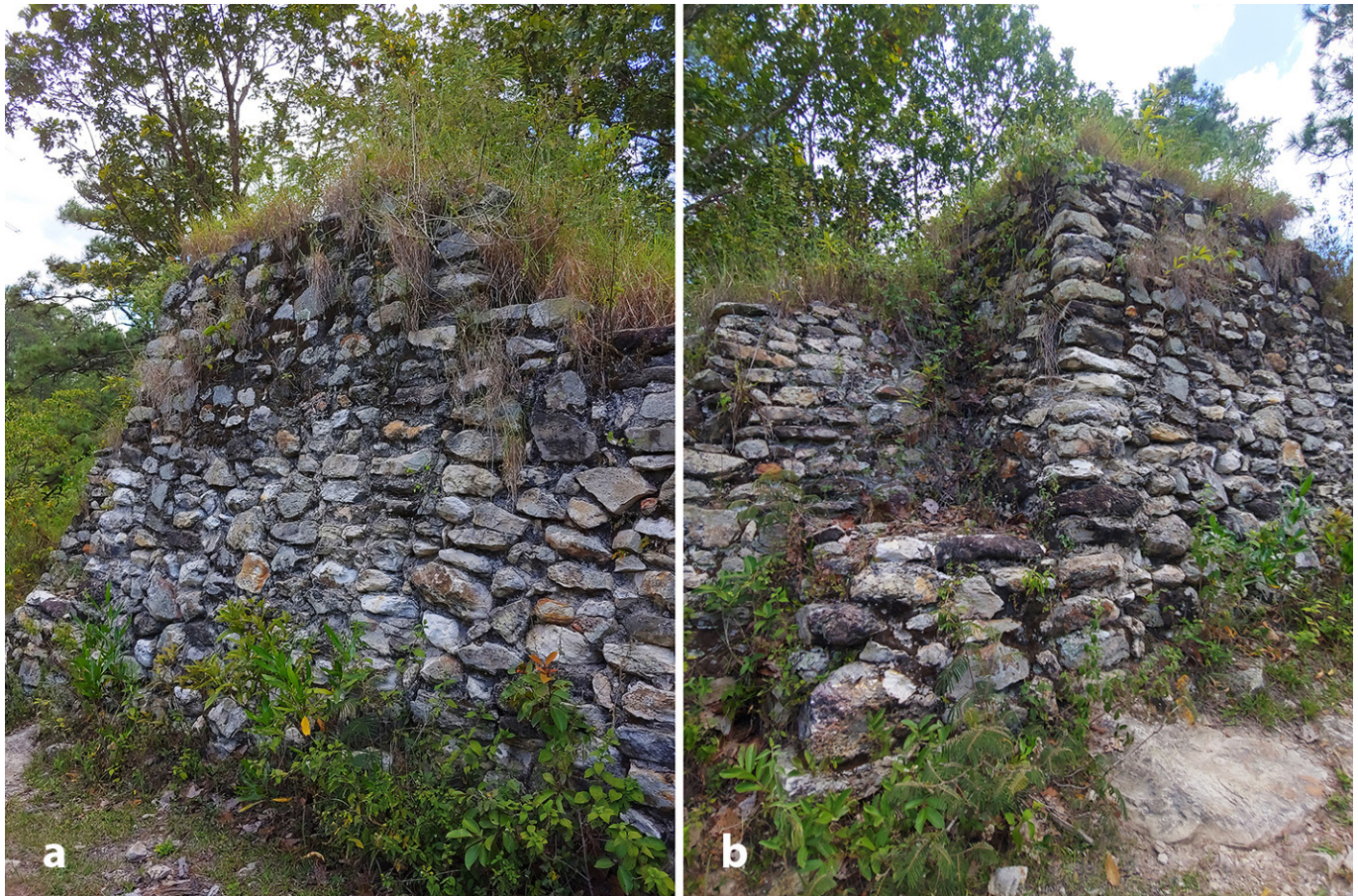
Figura 4: Corte transversal de una sección del muro perimetral restaurado al este de Tenampúa: a) vista del relleno interior de la construcción; b) vista posterior. Fotografías por K. Deras.
