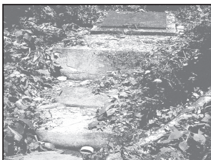
Foto 3: Toma de agua artesanal para un conjunto de viviendas. La forma en que ha sido construida, no asegura una buena calidad del líquido.
