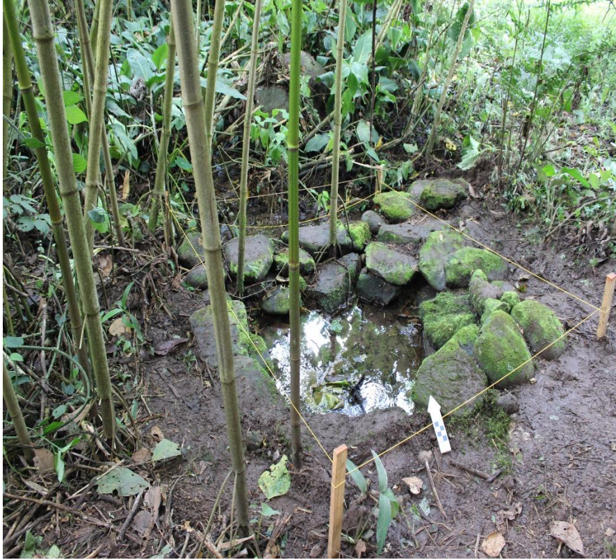
Figura 2. Caja de captación de agua, sitio Rosa María, denominada por los propietarios como el “Tanque Mama Moma”.
