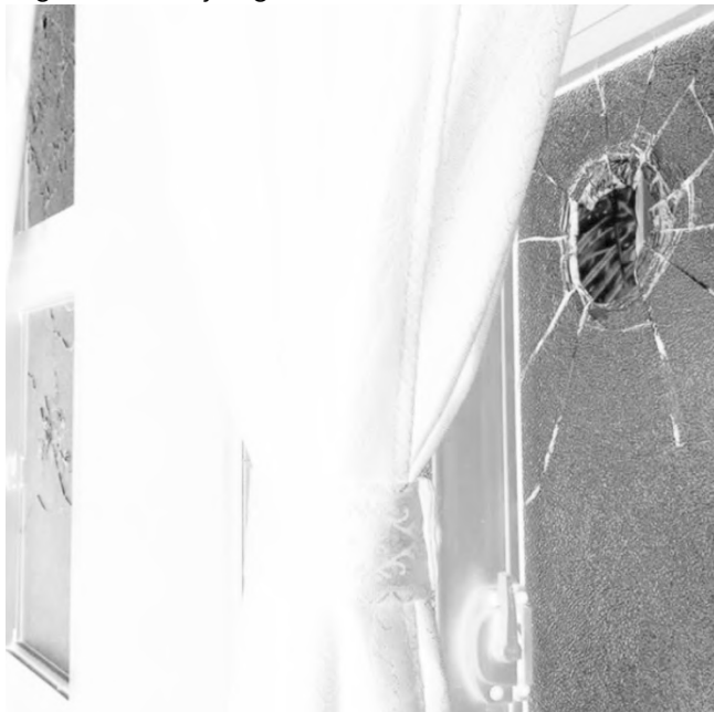
Figura 14. Perforación de proyectiles en los vidrios de la Iglesia, en la fachada Sureste. Imagen editada a negativo blanco y negro
