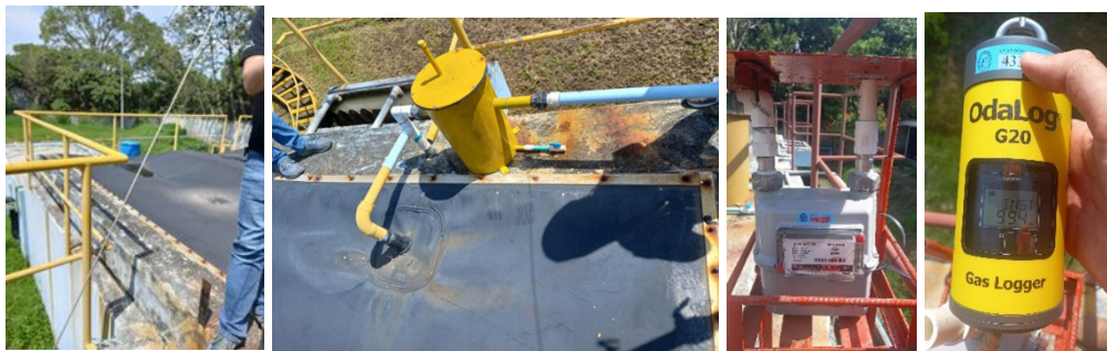
Fig. 1. Reactor anaeróbico tipo UASB: (a) vista superior del reactor; (b) salida de gases (sello hidráulico) provenientes del separador trifásico y compartimiento de decantación; (c) medidor de biogás; (d) medidor de \text{H}_2\text{S} .
