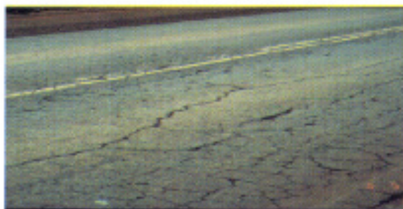
Figura No. 2: Agrietamiento por cargas repetidas (fatiga).
