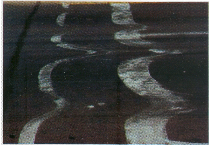
Figura 2: Corrugación provocada por flujo plástico en la capa asfáltica.
