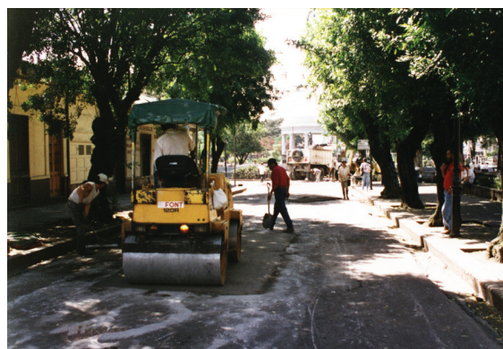
Fotografía 7. Bacheo “Paseo de las Damas”
