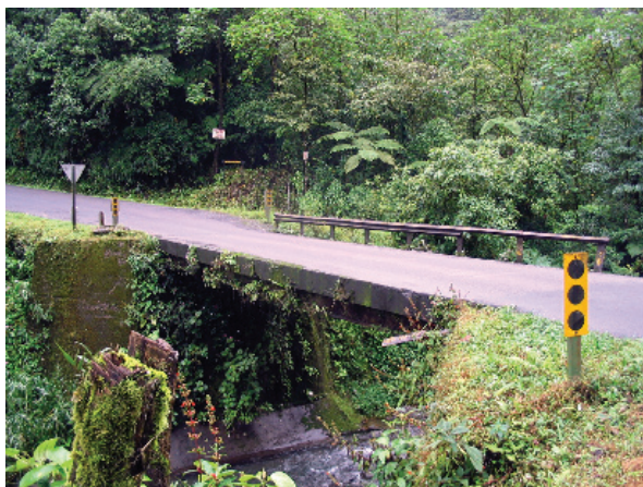
Puente sin protección lateral (baranda) en un sentido de circulación
