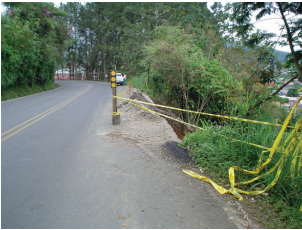
Señalamiento deficiente de un deslizamiento de talud en una vía
