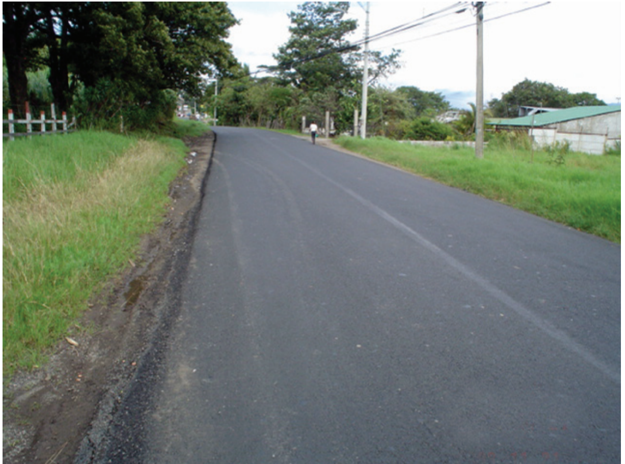
Obra de conservación vial en la cual sólo se mejora el pavimento y no se construyen facilidades peatonales
