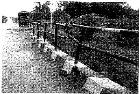
Foto 15. Indicios de la socavación en el terraplén de acceso. Puente Torcoragua (Colapsado recientemente por socavación, con pérdidas de vidas humanas)
