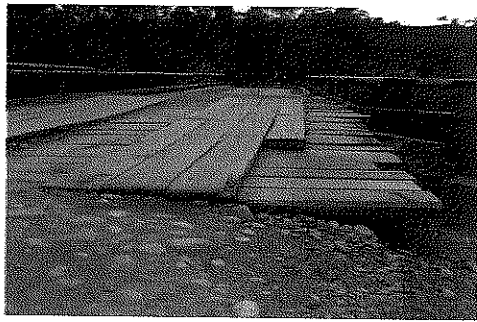
Foto 14. Socavación y pérdida de la totalidad del material en el terraplén de acceso. Puente Cruce Yarumo (Putumayo)
