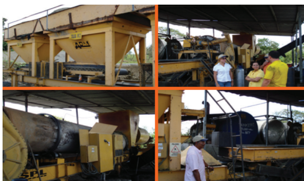
Figura 5 Planta asfáltica tipo
