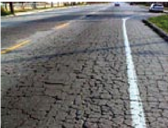
2a. Agrietamiento severo
