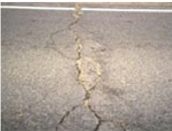
4c. Agrietamiento transversal con desprendimiento de borde
