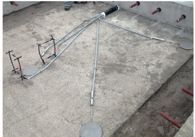
Figura 5. Instrumentación del pavimento rígido del AIJS (LanammeUCR, 2015)
