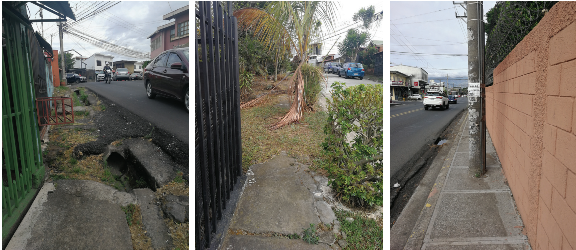
Figura 4. Obstrucciones en las vías peatonales del área de influencia de la parada de autobús en las Instalaciones Deportivas Nota: Fotografías tomadas de Segura, 2019
